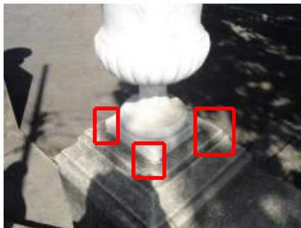
Figura 8 – Em destaque, marcas da tentativa de retirada de um dos vasos originais da parte externa do palácio, localizados ao lado direito do Jardim Terraço.
